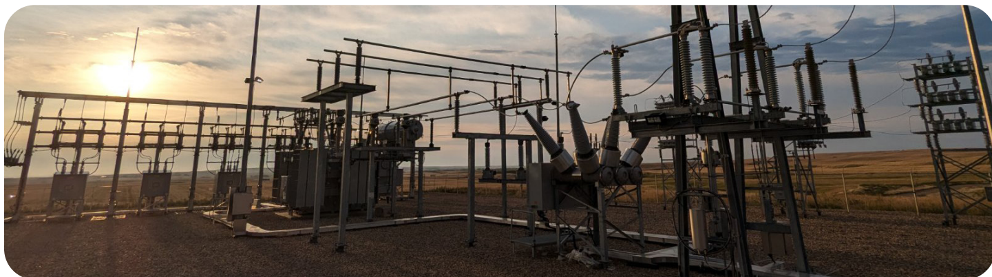
Figure 1 : Sous-station du Projet éolien Hand Hills
