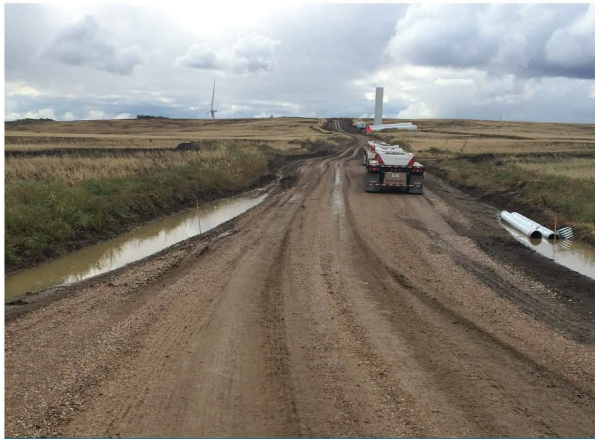
Travaux civils : la construction des routes et des aires de travail commence.
